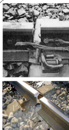
レールが折れた！ (写真上)09年3月、京葉線の葛西臨海公園〜新木場間で開口約30mmのレール破断(下)JR江差線レールの破断。溶接不足か、発見が遅れば脱線も(09年3月)。
